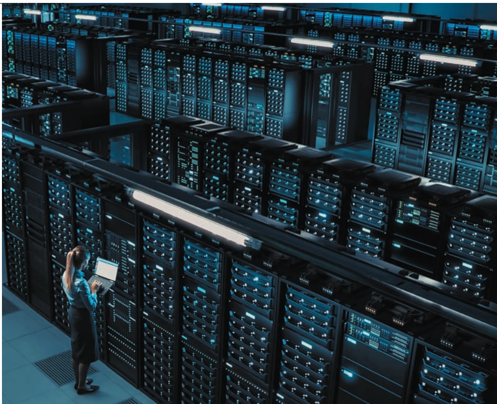
Rechenzentren, KI und Energie: die strategischen Investitionen, die heute das Wachstum in den USA tragen.
